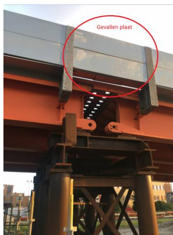
Figuur 3 - Locatie gevallen stalen plaat
