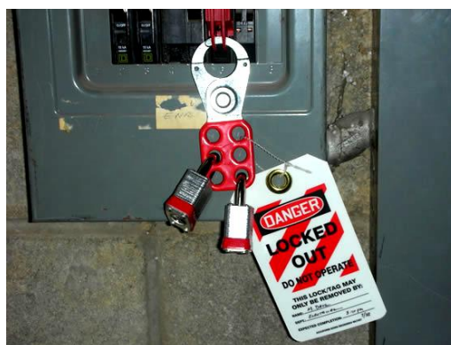
Foto van beveiliging tegen inschakelen met behulp van Lock Out en Tag Out middel.
