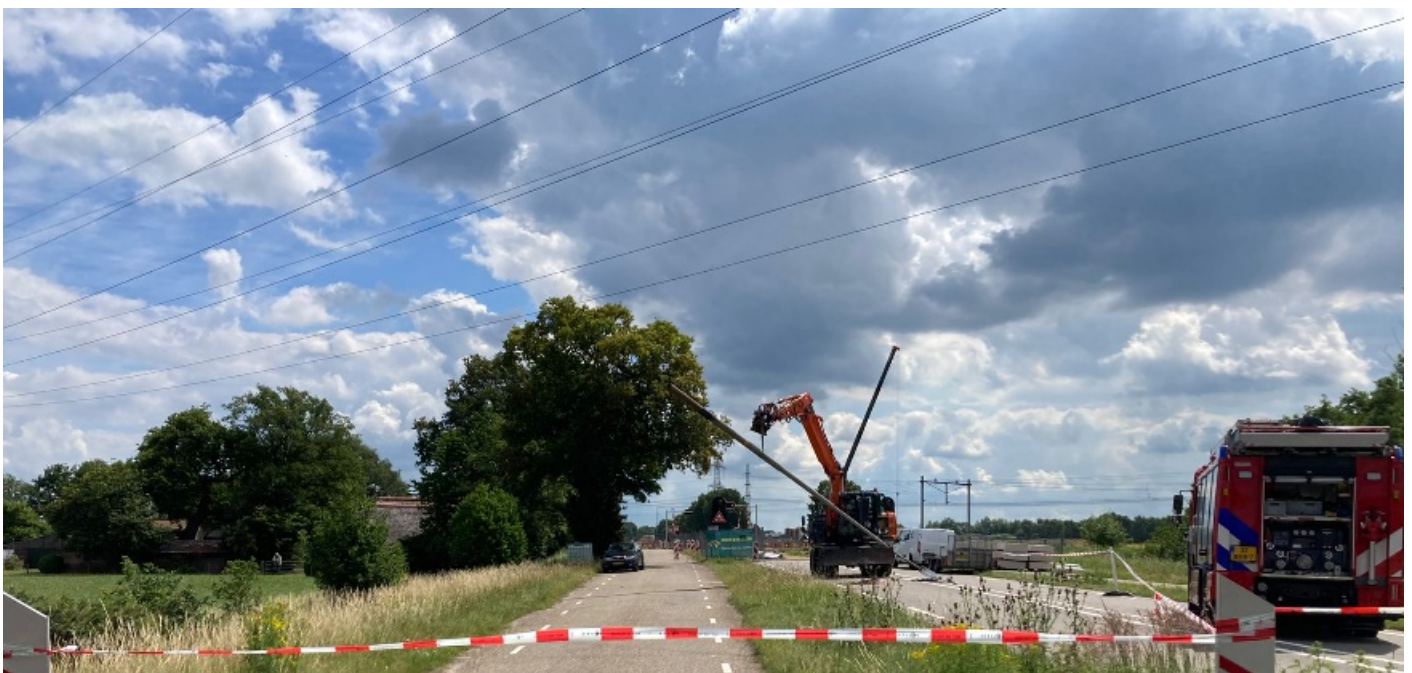
Foto van het incident. De giek van de kraan stond ten zijde van het ongeval hoger, waardoor de lichtmast in de risicozone van de hoogspanningslijnen kwam (= 3 meter bij 110kV).
